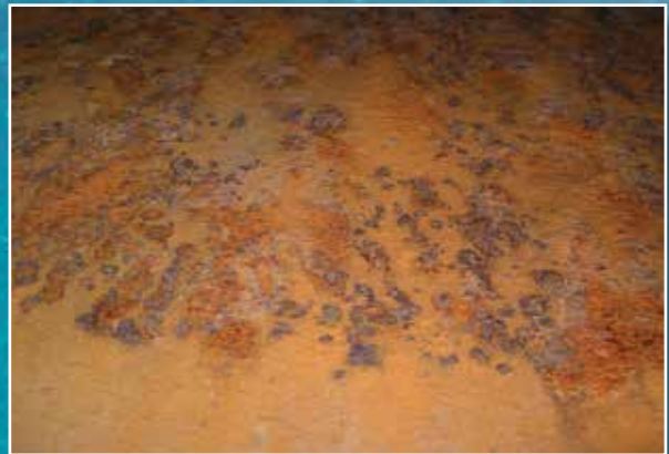
Corrosión general sobre la placa del casco.
