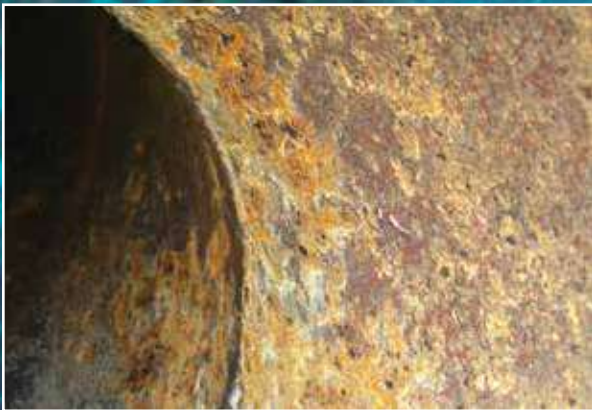
Corrosión en forma de hoyos alrededor del escape de gases.
